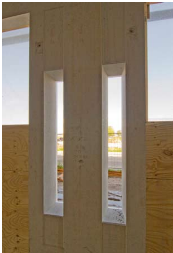
Het binnenspouwblad achter de zwarte gevelbanden van binnenuit gezien, in de 'schiegaten' komen ventilatieluiken, de glasgevels tussen de zwarte gevelbanden kunnen niet open maar bestaat uit een klimaatgevel, een tweevoudige glazen gevel met een spouw van 30 cm die bovenaan afgezogen wordt. De overtollige warmte wordt opgeslagen in de bodem voor gebruik in de winter
